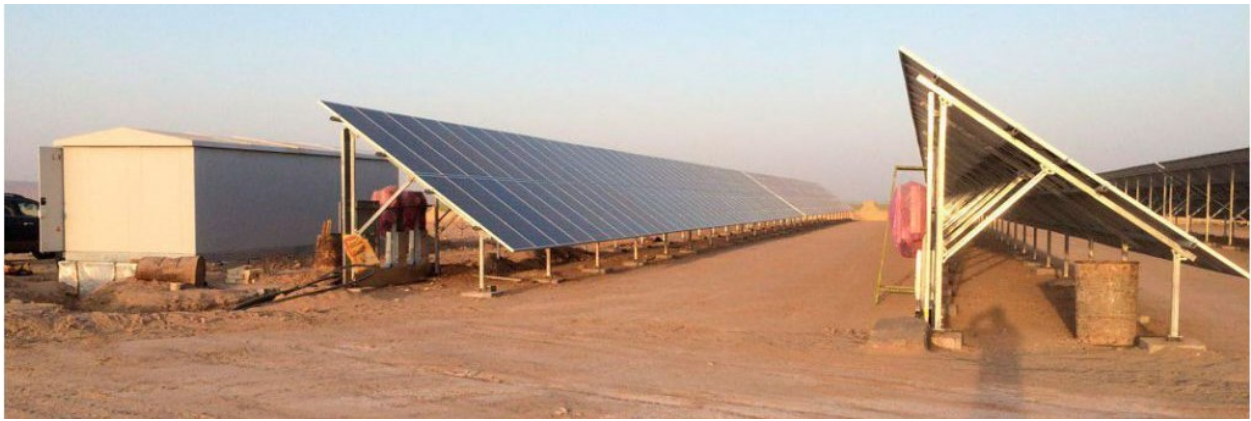
شکل ۷: نیروگاه خورشیدی اراک با ظرفیت 1MW
